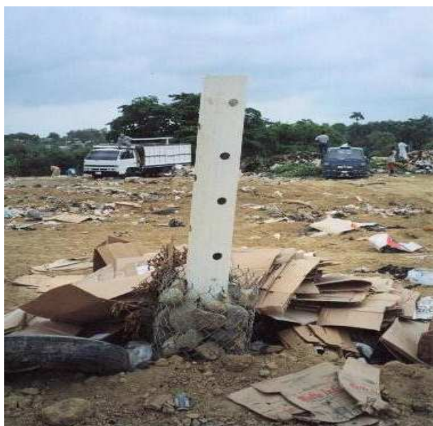
Système de récupération de gaz et de lixiviats dans la décharge de Moca
