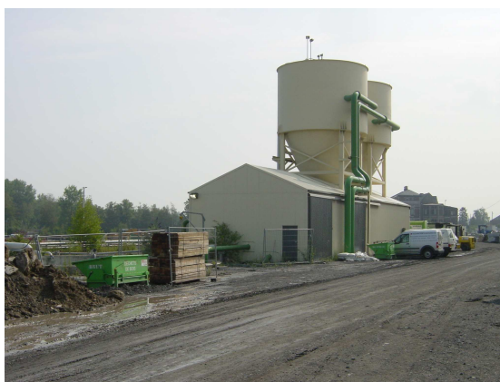
Figure 5-3. Station d'épuration des eaux usées industrielles
