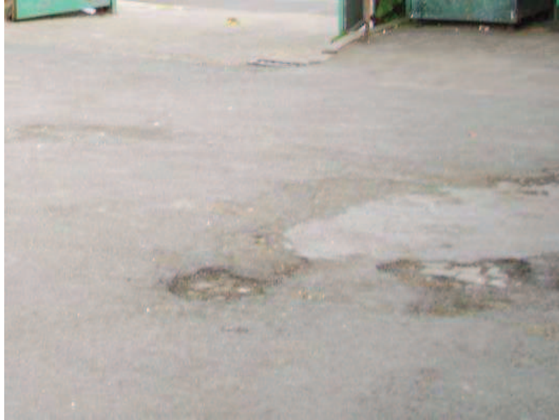
Photo 4 : Trous dans l'asphalte (543 chée de Waterloo) – photo personnelle du 24/04/08
