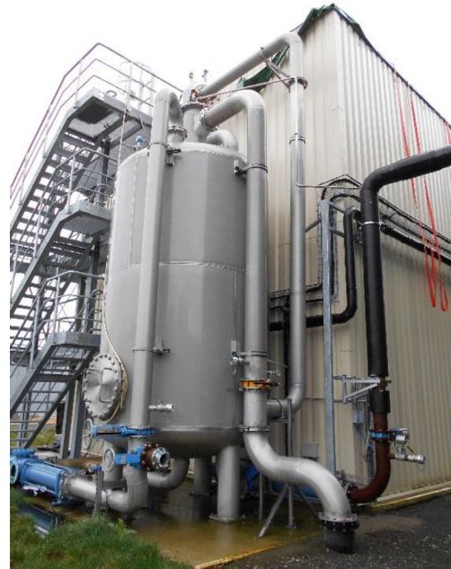
Fig. 20. Cuve tampon du digestat brut, prise à La Ferté Saint-Aubin (Photo personnelle, 31 mars 2016)
