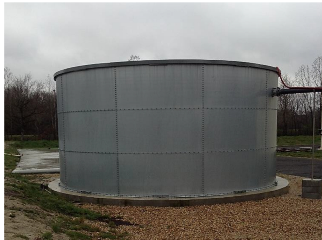
Fig. 21. Cuve de stockage temporaire du digestat liquide, prise à La Ferté Saint-Aubin (Photo personnelle, 31 mars 2016)
