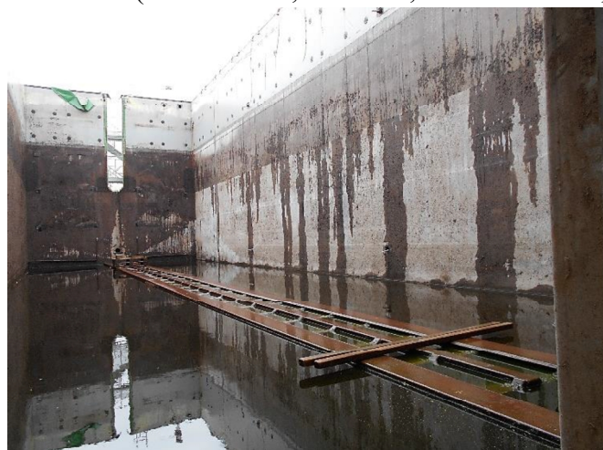
Fig. 18. Digesteur horizontal, prise à La Ferté Saint-Aubin (Photo personnelle, 31 mars 2016)
