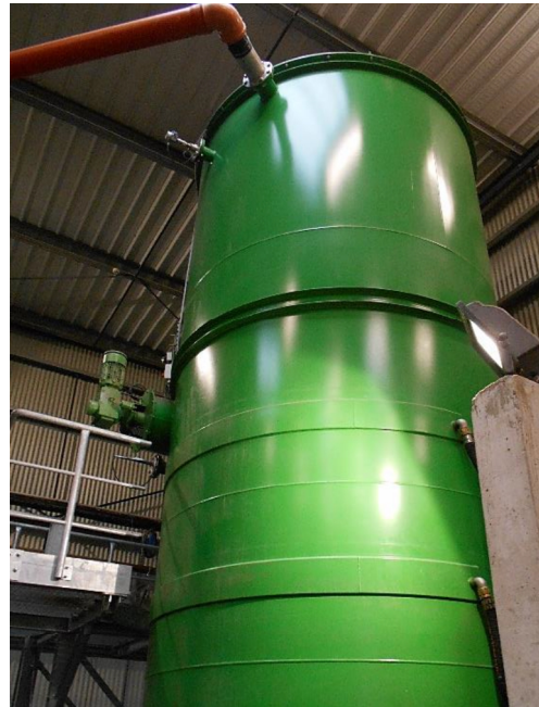
Fig. 17. Cuve d'hydrolyse, prise à La Ferté Saint-Aubin (Photo personnelle, 31 mars 2016)
