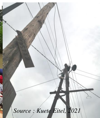
Photo 8: Branchements électriques illégaux à Kouougou
